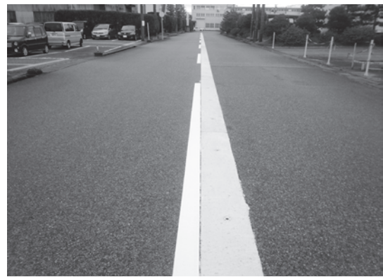
団地内の市道に完成した融雪装置
