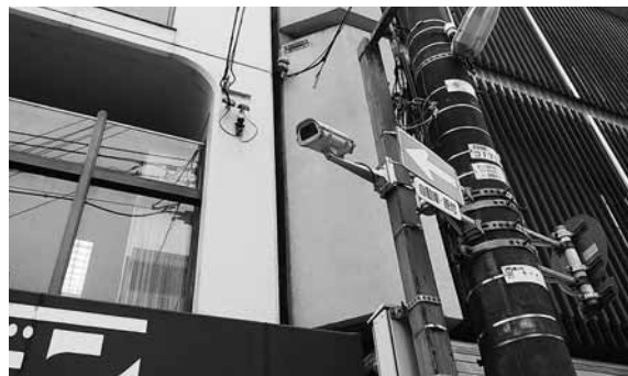
組合で設置した防犯カメラ
