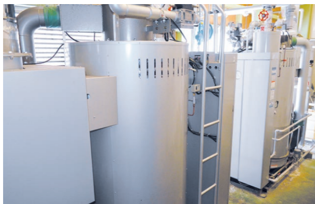
補助金で導入されたLPガスコントロールボイラー2台
