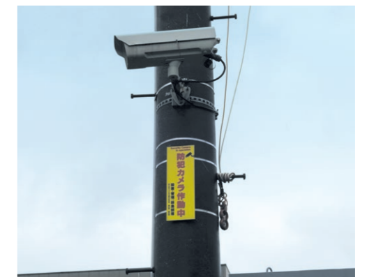
地元町内会の要請を受け、組合で設置した防犯カメラ
